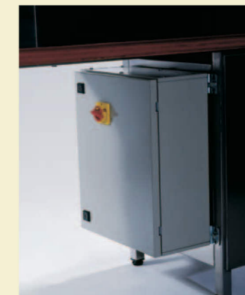
Quadro elettrico con interruttore generale
